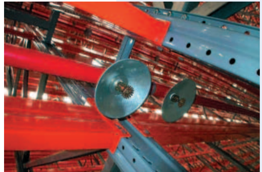
Das Lager ist komplett besprinklert. Die Bühne ist mit brandhemmenden MSB-Platten belegt
