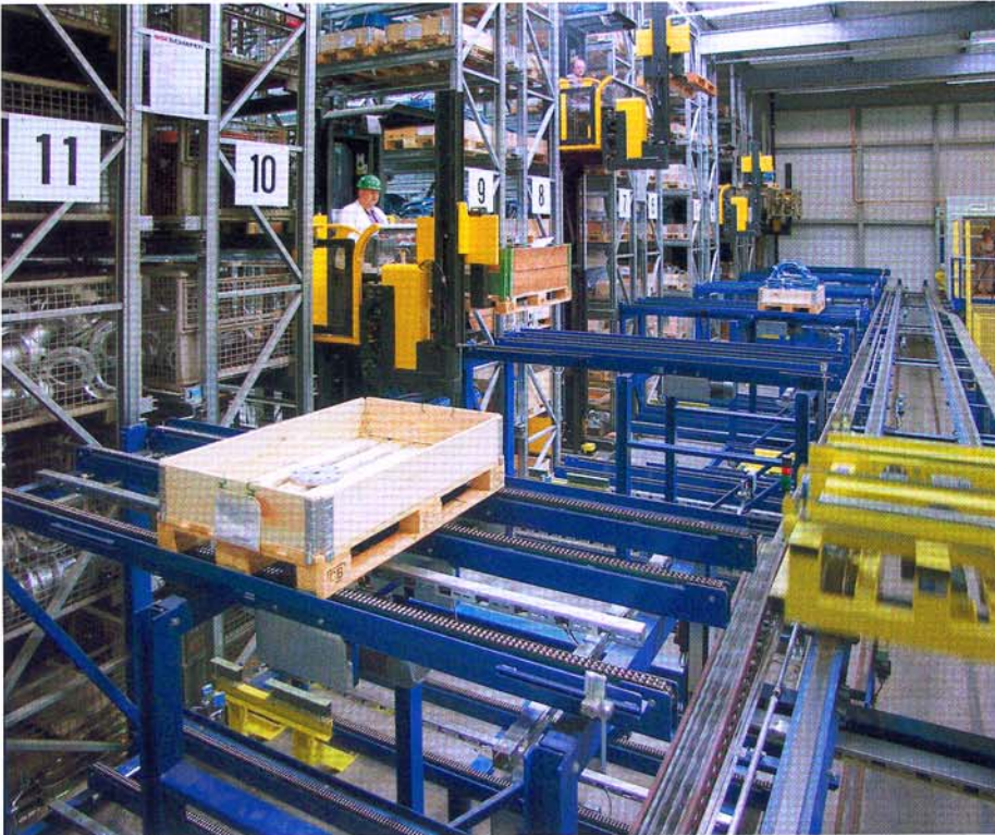
Das Hochregal bietet Platz für 5.400 Paletten bzw. Gitterboxen. Ein wesentliche Rolle spielt das zielkoordinierte Bereitstellen der Ladungsträger.
