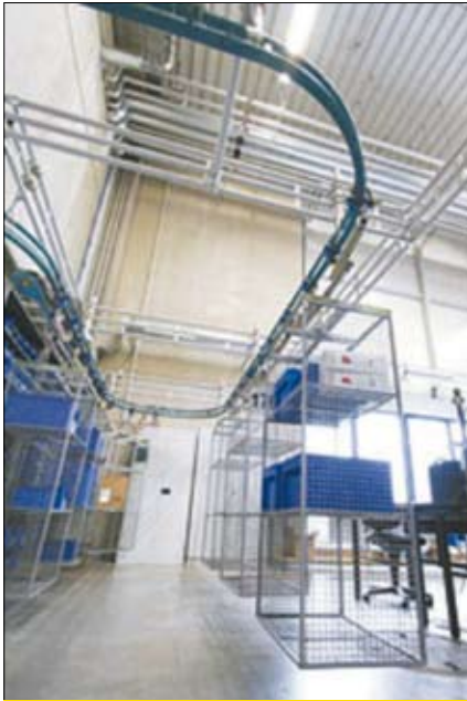
Wisząca kolejka transportująca wózki, z szeroko rozgałęzionym systemem szynowym oraz zwrotnicami przebiegającymi przez zapory świetlne.
